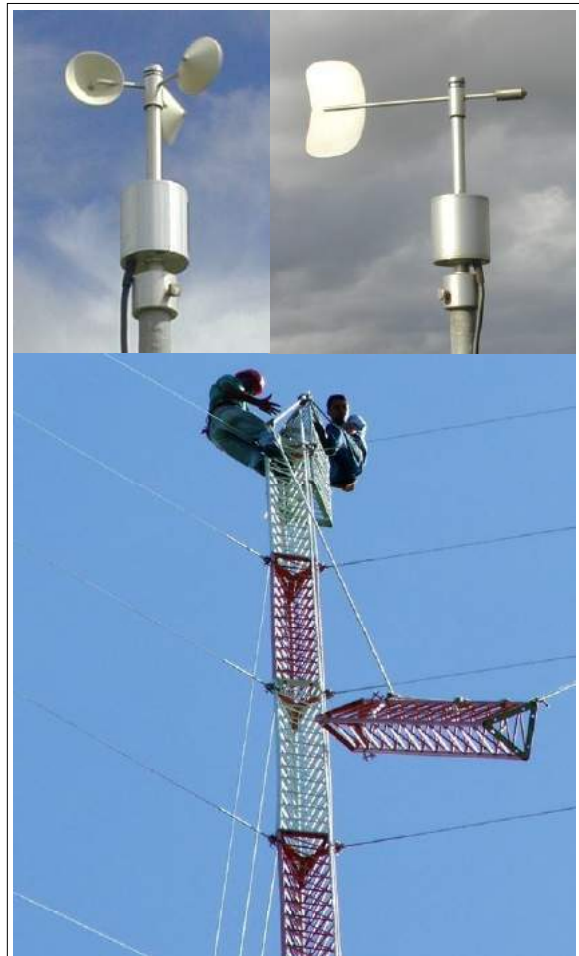
Figura 3.4 - No topo, anemômetro e sensor de direção utilizado pela Eletrobrás no Estado de Alagoas. Em baixo, montagem de uma das torres da Eletrobrás (100m de altura, após concluída).
