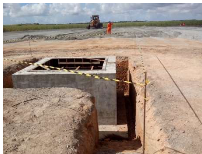
Figura 10 – Ante poço finalizado
