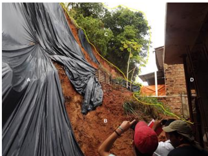
Figura 2: Registro fotográfico da área 1, destacando (A) medida de contenção da encosta realizada pela Coordenadoria Municipal de Defesa Civil - COMDEC, (B) Solo carreado pela ação do escorregamento, (C) Vegetação predominante de restinga, (D) Imóveis na base do talude. Fonte: Autores, 2015.
