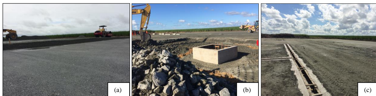
Figura 04 – Locação OSMC 01 na fase de revestimento brita corrida (a); e no reforço do subleito e sub-base (b); canaletas de contenção (c);
